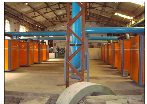
Sala de bombas con 10 x UV50 VS90 HC
